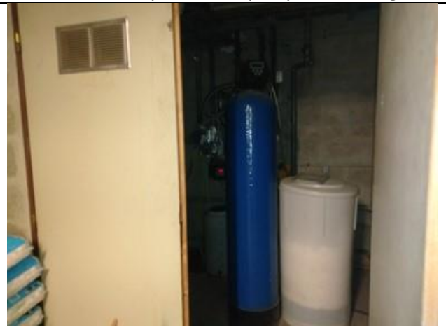
Chaufferie bâtiment est – sous-sol
